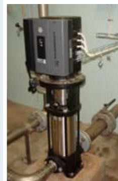
Grundfos CRE 15-07, Arvika Edane Vattenverk
