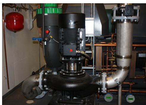
2 Grundfos TP inline-pumpar verkar som köldbärare från kylmaskinen.
