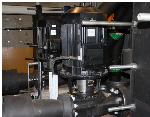
2 energieffektiva TP 125-580 inline-pumpar distribuerar ut kylvattnet i fjärrkylanätet på Luleå Energi.
