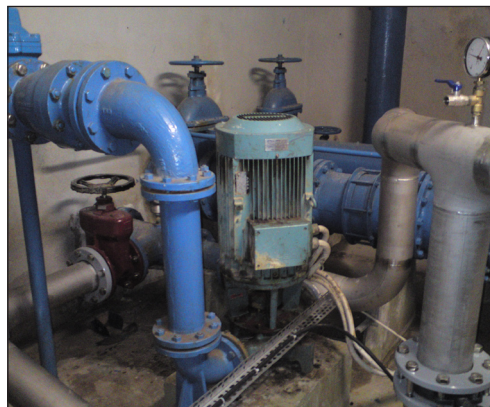
Dåvarande tryckstegringslösning för vattenförsörjning till 250 hushåll i Smedjebacken. En äldre pump på 22 kW.
